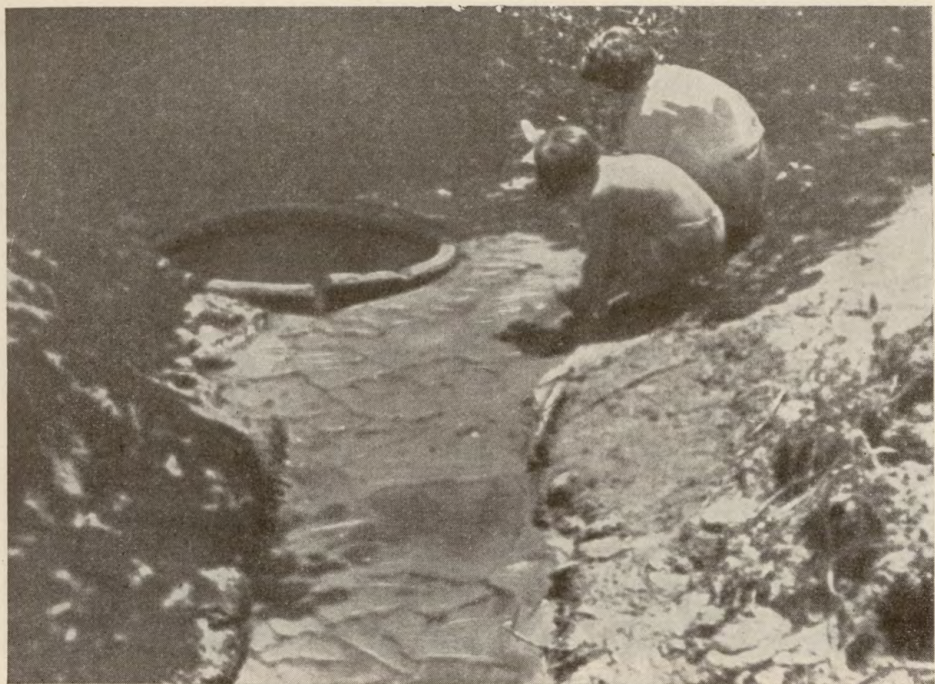
52. ábra. BETONGYŰRŰVEL VÉDETT FORRÁS
