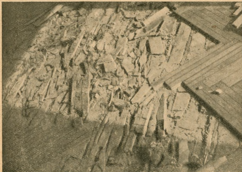
36. ábra. A vakpadló reves (destrukciós) korhadása
